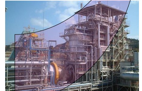
発電・工場プラント
